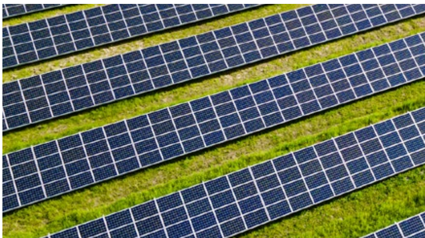
Quadro 69 - Usina fotovoltaica
